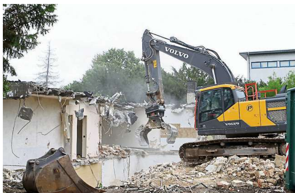
An der Albert-Schweitzer-Schule wird das ehemalige Hausmeistergebäude abgerissen und Raum für die Schulkinderbetreuung geschaffen. Foto: Ulrich von Mengden
